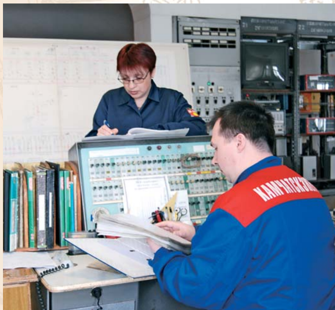
ТЭЦ-2, главный щит управления. 2009 г.
