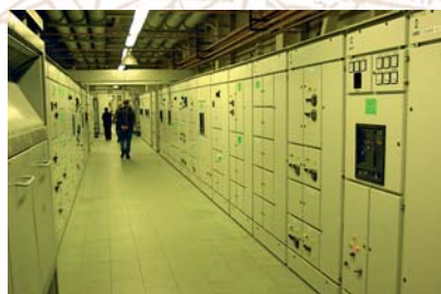
РУ 10 кВ. МгеоЭС
