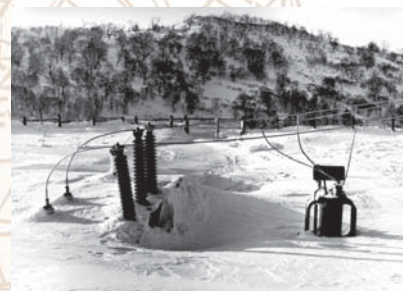
Подстанция «Северная» после пурги. 1980-е гг.
