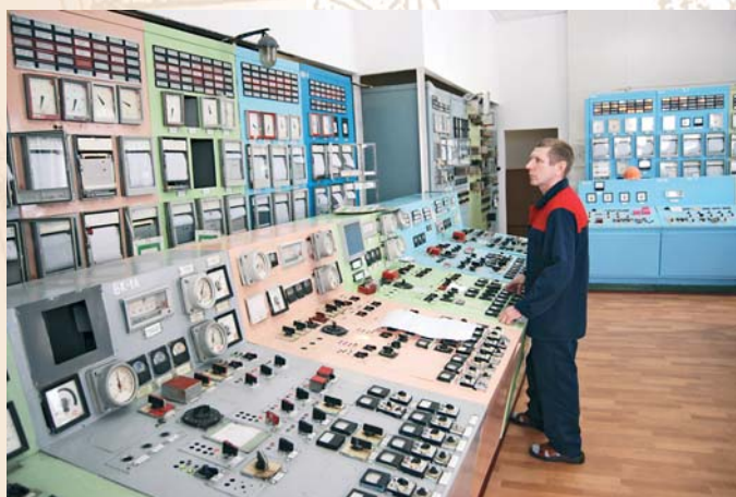
ТЭЦ-1, щит управления турбиной. 2009 г.
