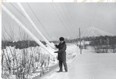
Гололедные явления на линиях электропередачи. Зима 1971 г.
