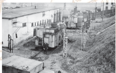
Подстанция «Зеркальная». Лето 1968 г.
