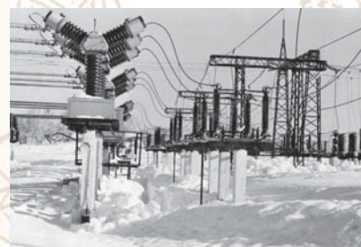
Подстанция «Камчатскстройматериалы». Март 1971 г.
