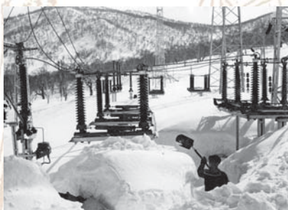
Подстанция «Приморская». Зима 1973 г.
