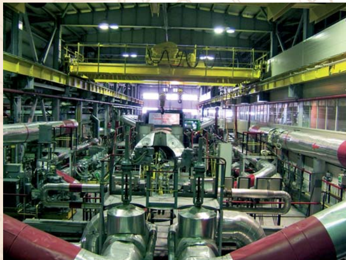
Машинный зал МгеоЭС
