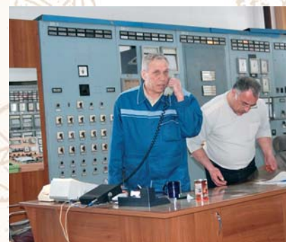
ТЭЦ-1, главный щит управления. 2009 г.
